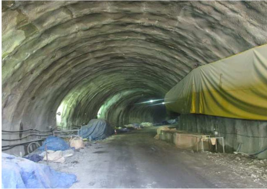
내부 환기시설 현황
