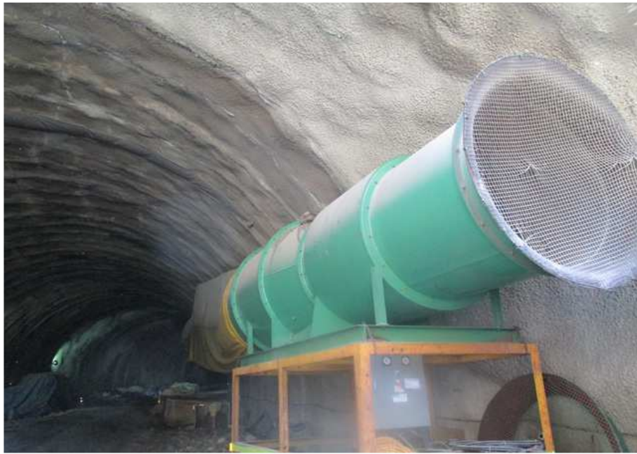
내부 환기시설 현황
